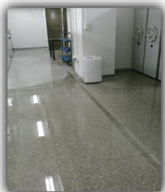
Penetración de agua por tragantes
